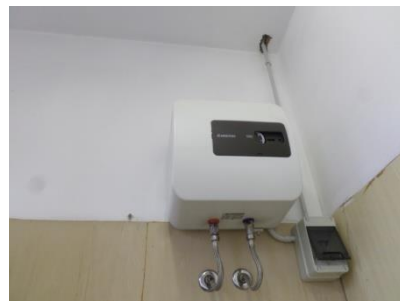
Figura 4.7 - Particolare del boiler elettrico per la produzione di acqua calda sanitaria]
