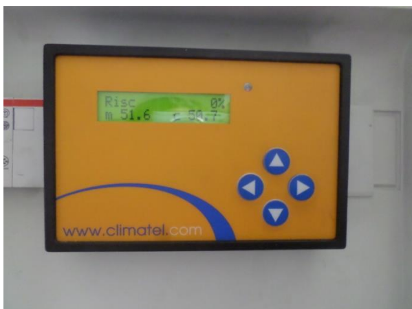
Figura 4.6 - Particolare della centralina di regolazione
